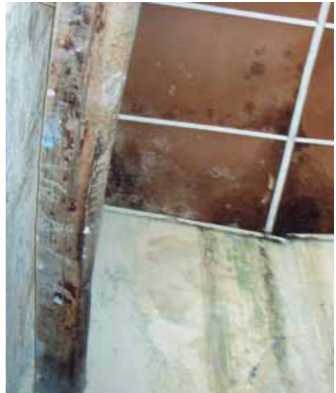
Cielo raso y vigas dañadas por la humedad. Iglesia de Comas. Año 2011.
