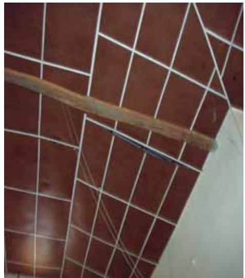
Vigas que sostienen el cielo raso debilitadas. Iglesia de Comas. Año 2011.
