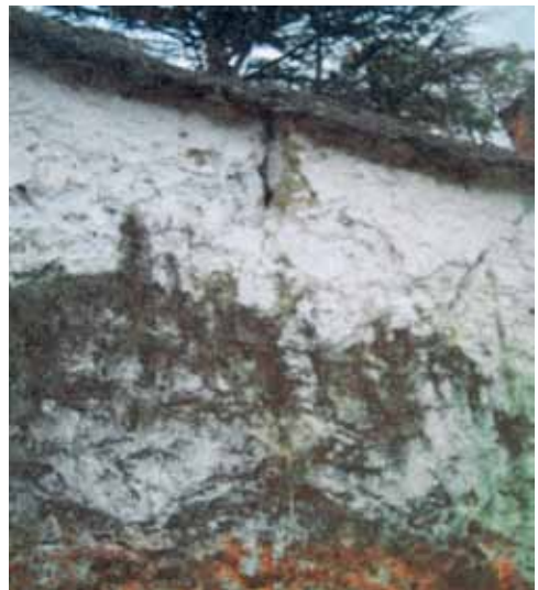
Paredes del cementerio rajadas antes de terminar la obra, distrito de Ulcumayo. Año 2007.
