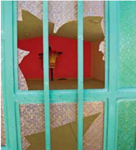
Ventanal roto de la capilla, distrito de Ondores. Año 2011.
