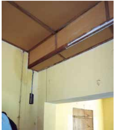
Filtraciones de agua en paredes y cielo raso, local comunal de distrito de Yanacancha, año 2011.
