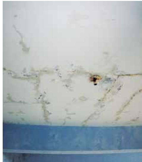
Filtraciones de agua en techo del ambiente Biblioteca comunal. Distrito Mariscal Castilla. Año 2011.
